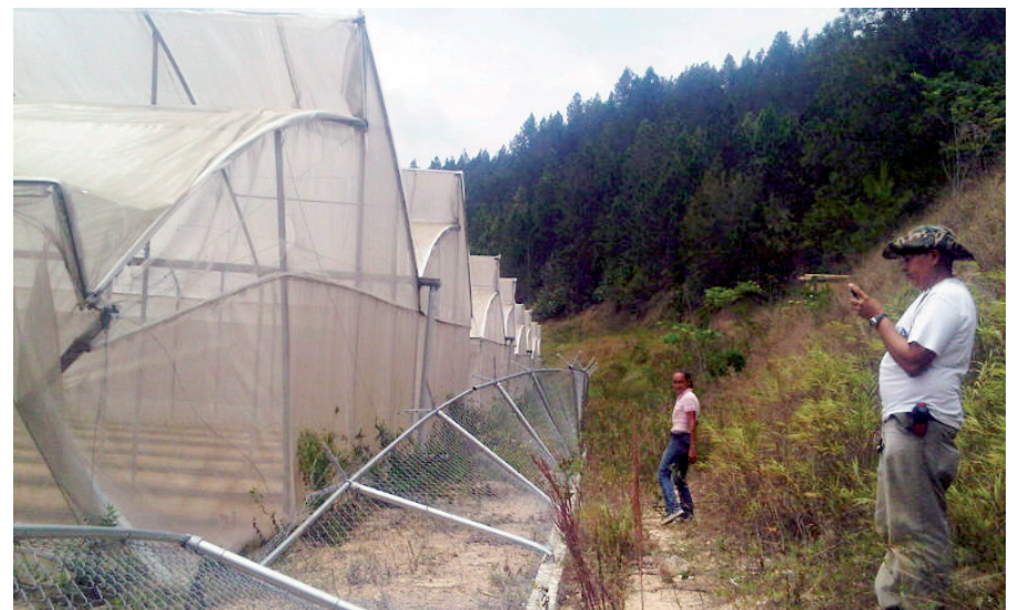
Los productores agricolas ven con asombro el daño causado a la propiedad social
