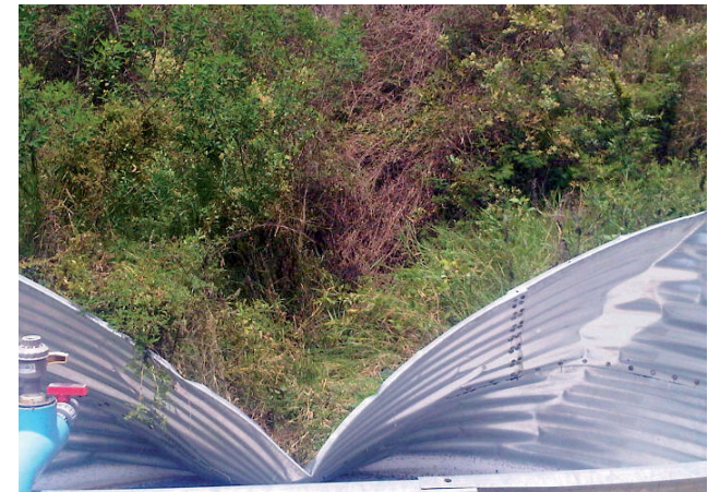
Daños causado al tanque australiano que sirve para piscicultura
