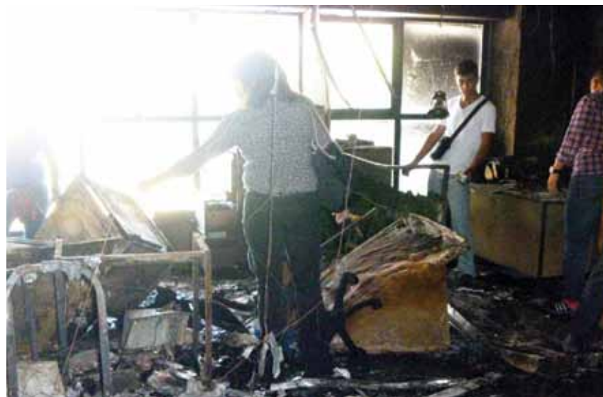
Destrucción de la sede de la Universidad Nacional Experimental de la Fuerza Armada en los Teques, estado Miranda, a manos de una banda violenta el 20 de marzo de 2014
